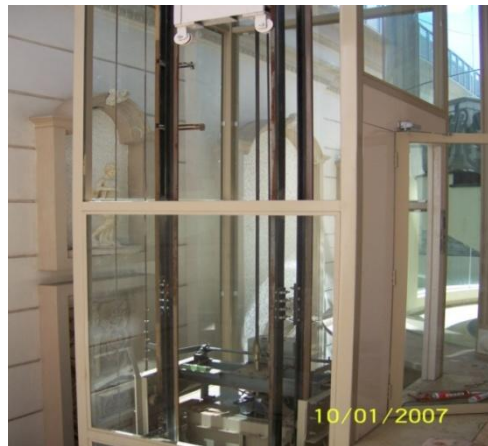
Gambar IV.2 Passenger Elevator (Sumber: PT Rekayasa Mitra Mandiri)
