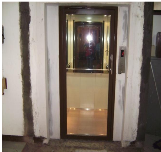
Gambar IV.3 Passenger Elevator (Sumber: PT Rekayasa Mitra Mandiri)
