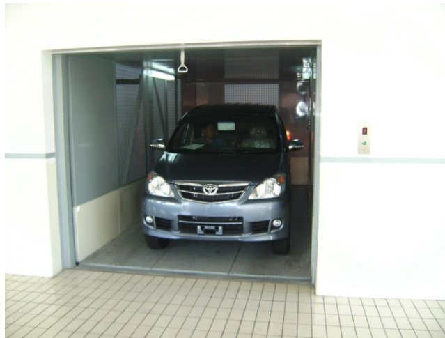
Gambar IV.4 Car Elevator (Sumber: PT Rekayasa Mitra Mandiri )
