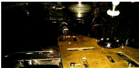
Gambar V.4 a. Mesin sebelum dilengkapi selang aliran pelumas
