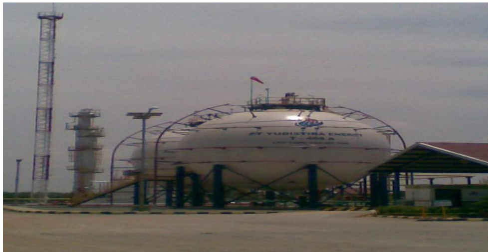
Gambar 4.3 Spherical Tank (Proyek LPG Plant Pondok Tengah) Sumber : (PT Gerbang Saranabaja)
