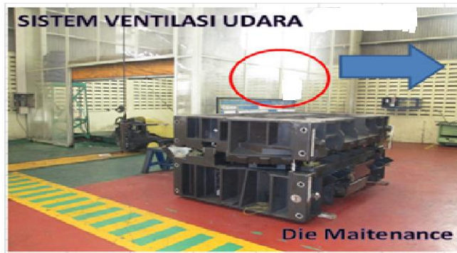
Gambar 5.5 Kondisi Pendingin Ruangan Sebelum Perbaikan (Sumber: PT Mekar Armada Jaya)
