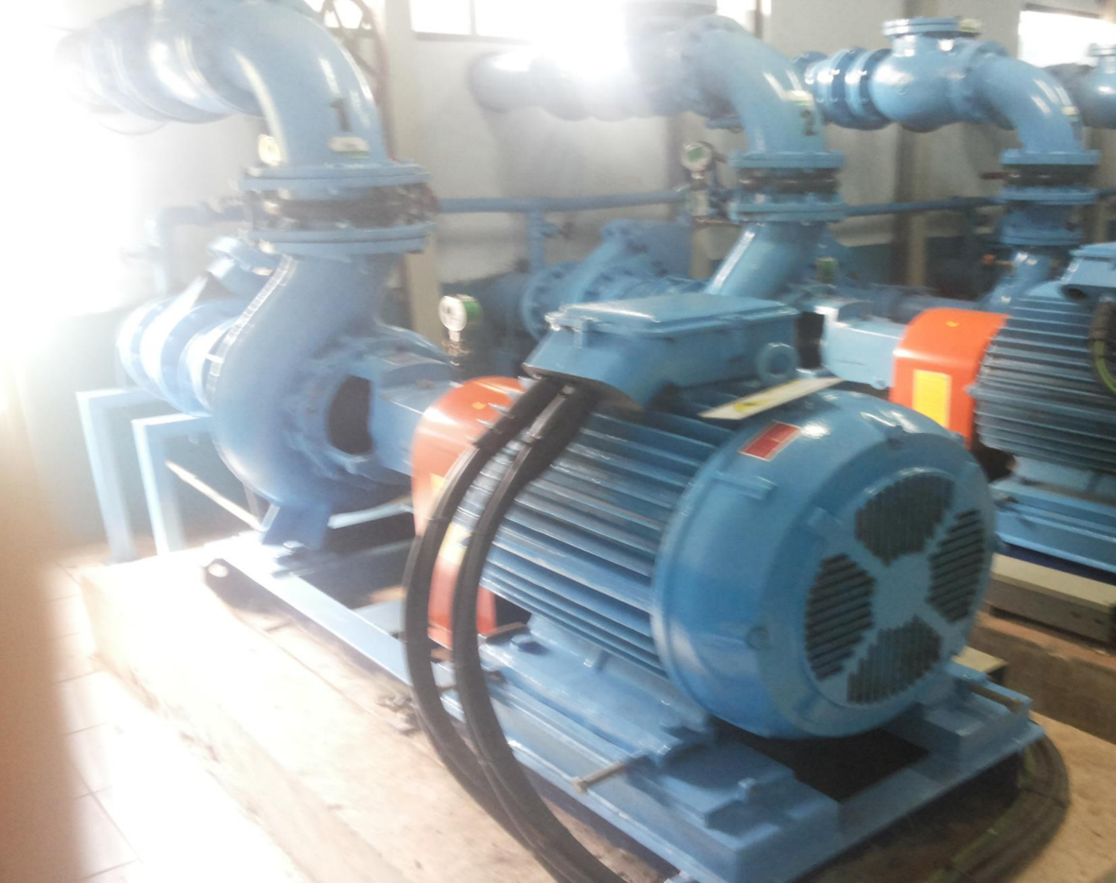
Gambar Mesin pompa Distribusi Instalasi Pengolahan Air (IPA) Taman Kota PT PALYJA
