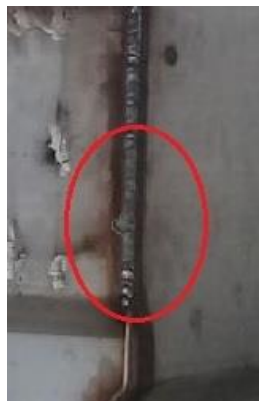
Gambar 4. 14 Cacat Under Cut (Sumber: PT Astanita Sukses Apindo)
