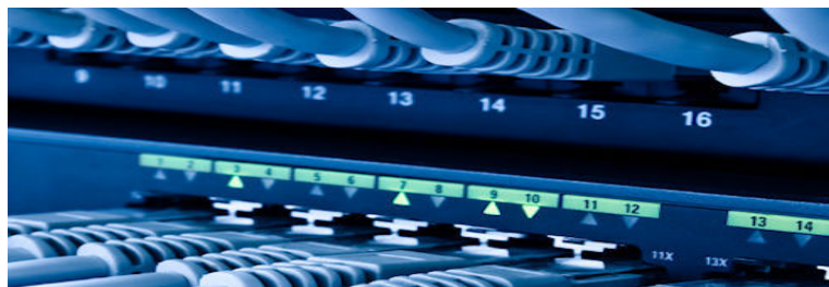
Gambar 4.10 Data Cabling dan Wiring (Sumber: PT Limawira Wisesa)
