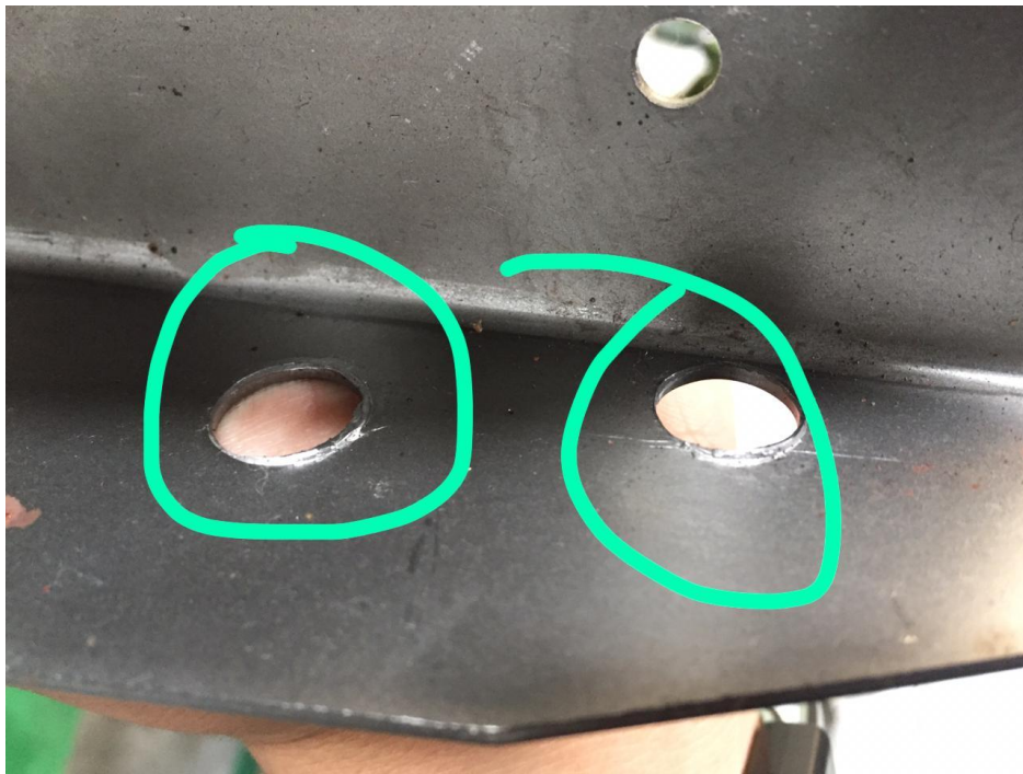
Gambar 4.13 Cacat hole geser (Sumber: PT Nusa Indah Jaya Utama)
